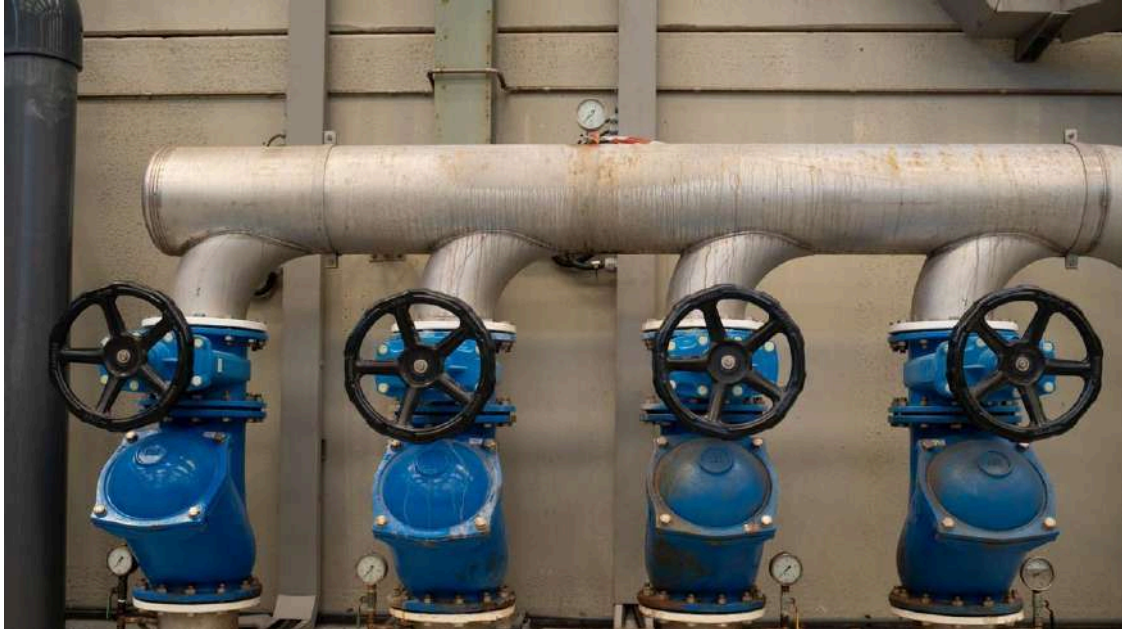
Conductos internos de la Estación depuradora del Baix Llobregat el día en el que Aigües de Barcelona explica su plan técnico de actuación ante la sequía.
